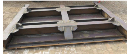
图1 一段时间后涂料剥落后的钢闸门
